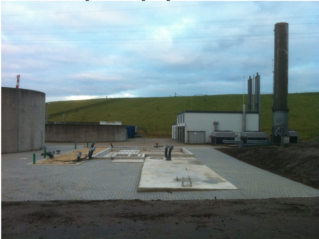
Foto: Fundamente Biogasaufbereitungsanlage
