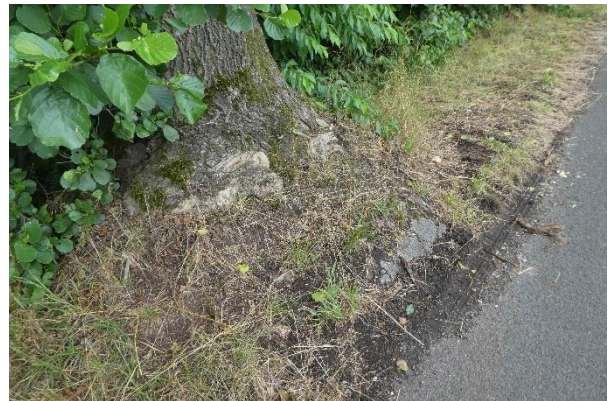
Foto 16: ... sind aber teils deutlich geschädigt
